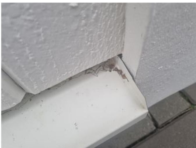
Exempelbild, otätheter mellan bleck/fasadbrädor/hörnbrädor.
