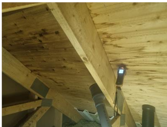
Underlagtak, vind. Avluftning avlopp (t.v i bild, grå) avslutas på vind utan membran, missfärgningar och fuktfläckar förekommer i underlagstaket i dess närområde. T.h i bild (svart rör) syns avluftningsventilen denna skall vara ansluten till/mot.
