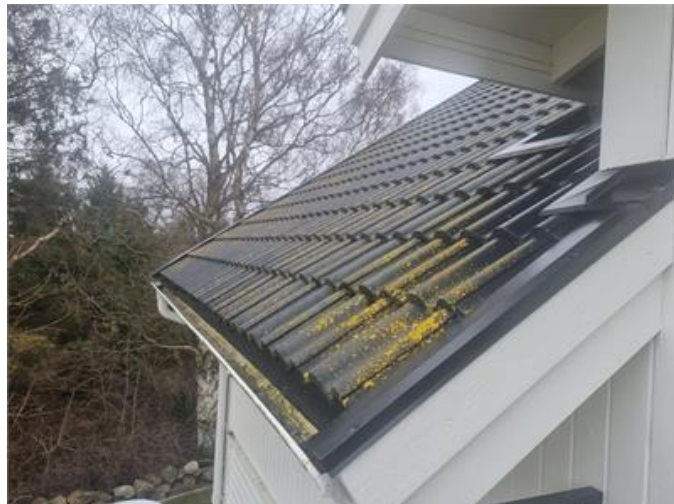
Översiktsbild yttertak med mosspåväxt på takpannor.
