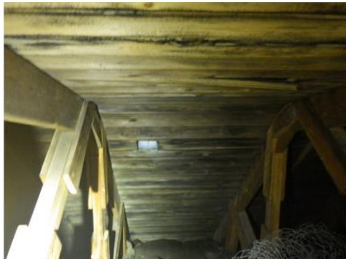
Mikrobiell påväxt samt missfärgningnockvind.
