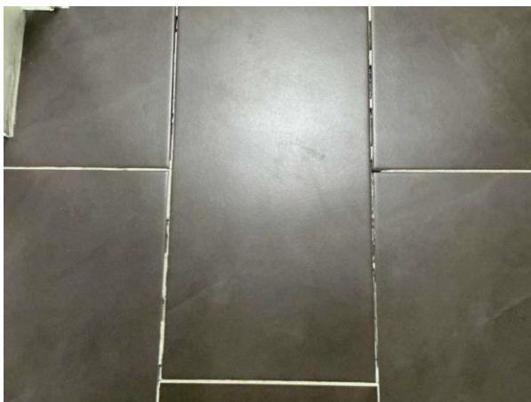
Bild 6: Invändigt, Övervåning, Tvättstuga, Fogsläpp finns på klinker Klinker plattor vid dörren är lösa
