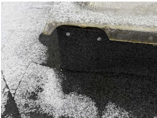
Bild 2: Utvändigt, Yttertak, Taket är snötäckt Plashuvorna ovan fönster är trasiga Del av pappen har släppt i en skarv vid en av fönsterna
