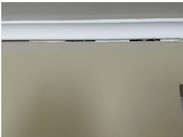
Bild 5: Invändigt, Övervåning, Allrum, En vägg glipar mot taklisten (se säljupplysningar övrigt)
