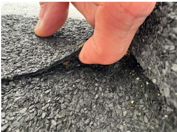
Bild 1: Utvändigt, Yttertak, Taket är snötäckt Plashuvorna ovan fönster är trasiga Del av pappen har släppt i en skarv vid en av fönsterna
