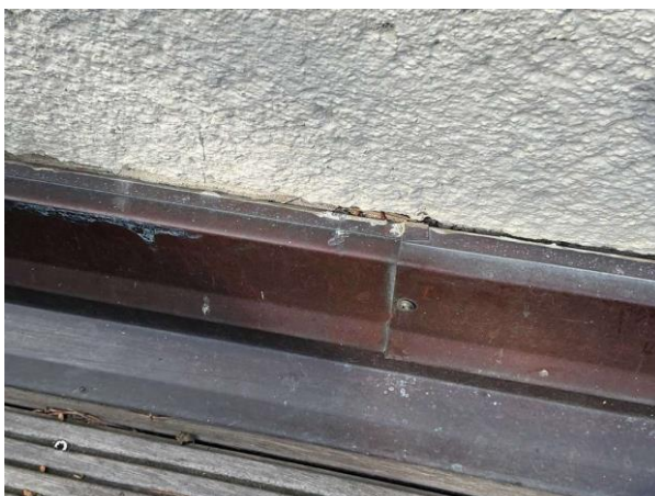
Bild 2: - Utvändigt, Fasad, Färgsläpp finns på fasaden Plåt mot fasaden vid altanen är något otät
