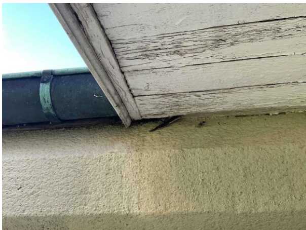
Bild 7: Utvändigt, Övrigt, Mindre rötskadad noterades i takutsprånget
