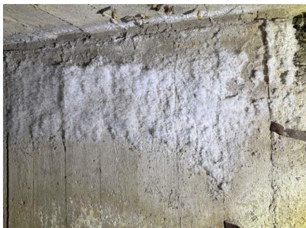
Bild 1: - Utvändigt, Grund, Kalkutfällningar på grundmur
