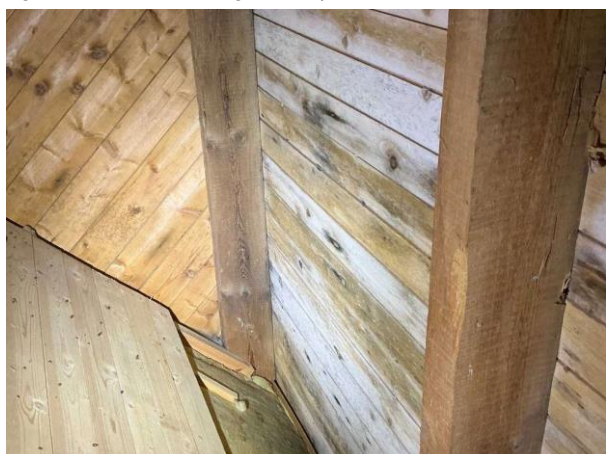
Bild 5: - Utvändigt, Vind, Mikrobiell påväxt på underlagstaket.
