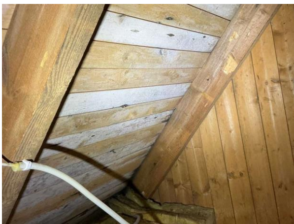
Bild 4: - Utvändigt, Vind, Mikrobiell påväxt på underlagstaket
