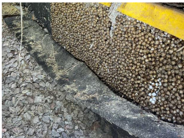
Bild 1: - Utvändigt, Mark, Fiberduk är lös och isodränskivor synliga under altan
