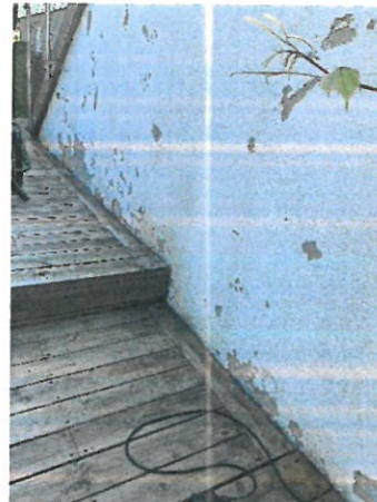
Bild 8: - Utvändigt, Fasad, Spricka i puts mellan tillbyggnad och äldre del Bomputs och lös puts på tillbyggnad samt gavel på...
