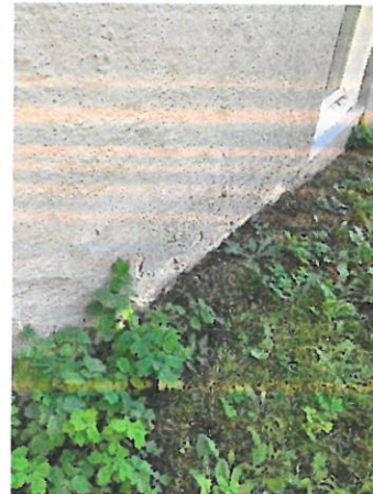
Bild 10: - Utvändigt, Grundmur/Hussockel, Platonmatta synlig ovan mark (skall täckas med mark) Lös puts vid dörr till förråd Lös färg noter...
