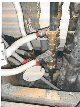
Bild 3: Invändigt, Entréplan, Tätskikt med läckageindikering saknas i inbyggnad för värmerörkopplingar och inbyggd spolcistern...
