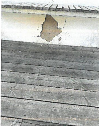
Bild 7: - Utvändigt, Fasad, Spricka i puts mellan tillbyggnad och äldre del Bomputs och lös puts på tillbyggnad samt gavel på...
