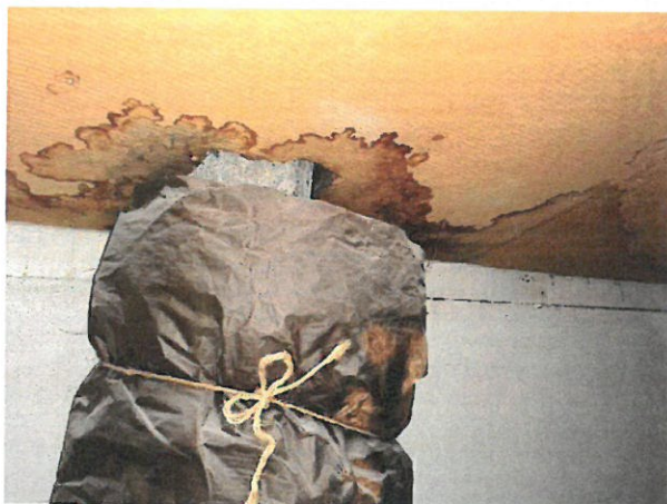
Bild 5: Invändigt, Övervåning, Äldre fuktfläck i tak innan takomläggningen
