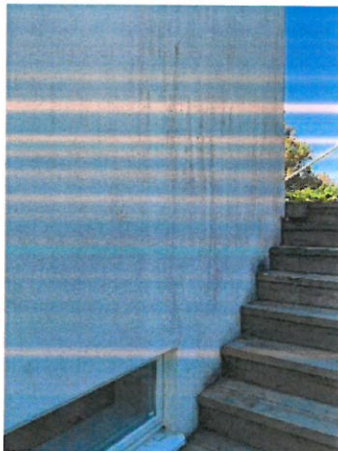
Bild 9: - Utvändigt, Fasad, Spricka i puts mellan tillbyggnad och äldre del Bomputs och lös puts på tillbyggnad samt gavel på...
