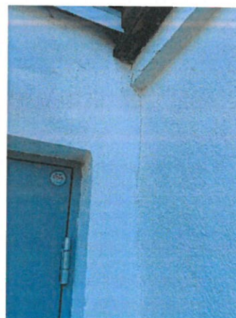
Bild 6: - Utvändigt, Fasad, Spricka i puts mellan tillbyggnad och äldre del Bomputs och lös puts på tillbyggnad samt gavel på...
