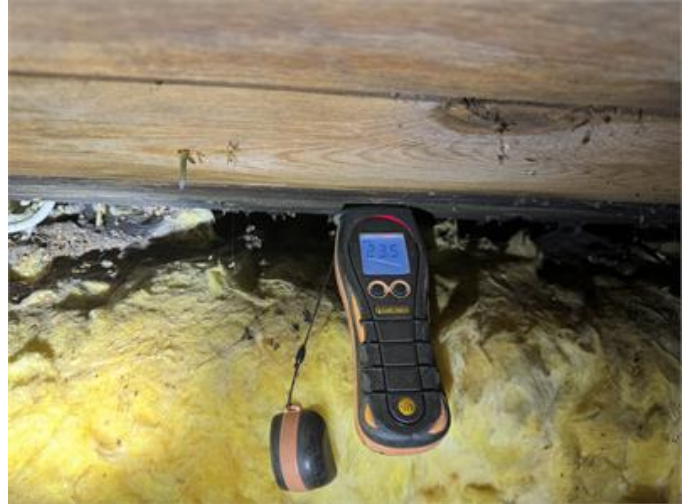
Förhöjda fuktvärden uppmättes mot underlagstaket.
