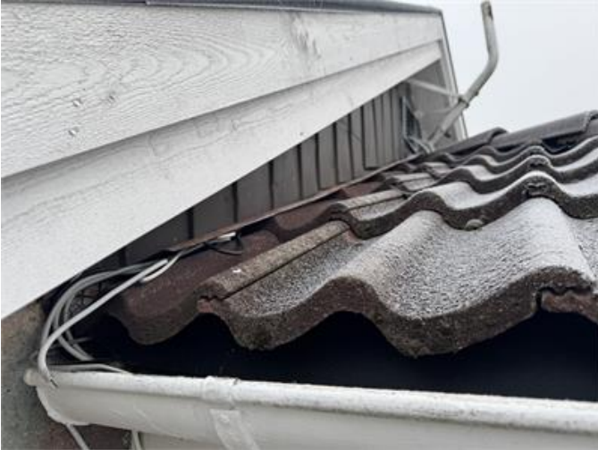
Plåtbeslag lutar mot fasad och är otät i dess nederkant.
