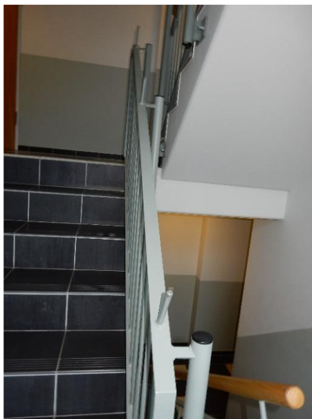
Bild 9 Trapphus, lejdare saknas
