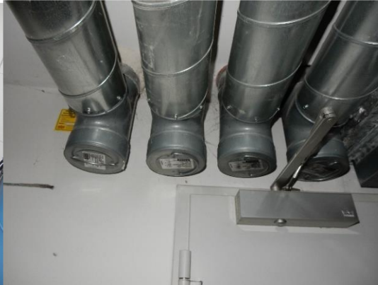
Bild 15 Ventilationskanaler i källaren
