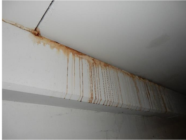
Bild 13 Läckage med rostutfällning, förmodligen
