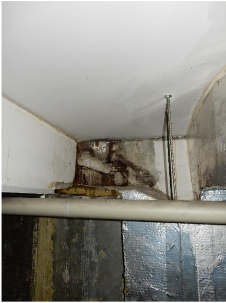
Bild 12 Läckage i garage upplagsbalk som utsatts för läckage och fukt
