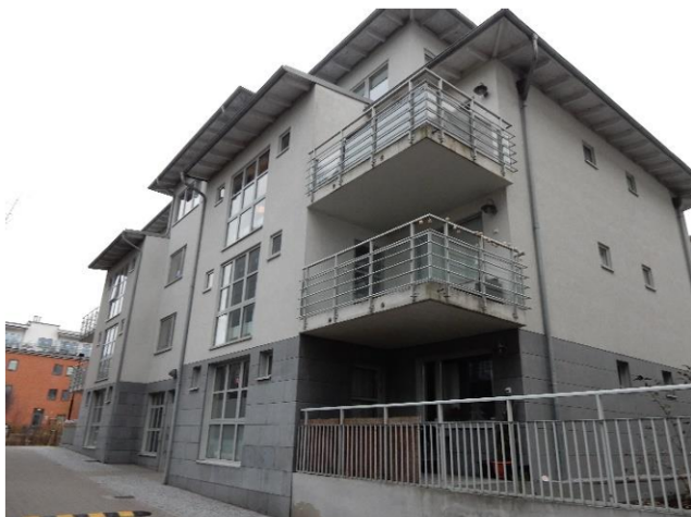
Bild 5 Fasad med färgskada på sockel
