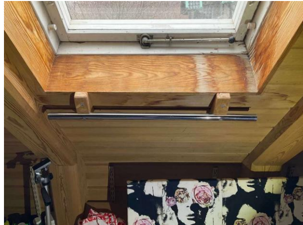
Bild 8: Invändigt, Övervåning, Missfärgningar noterades runt takfönstret.
