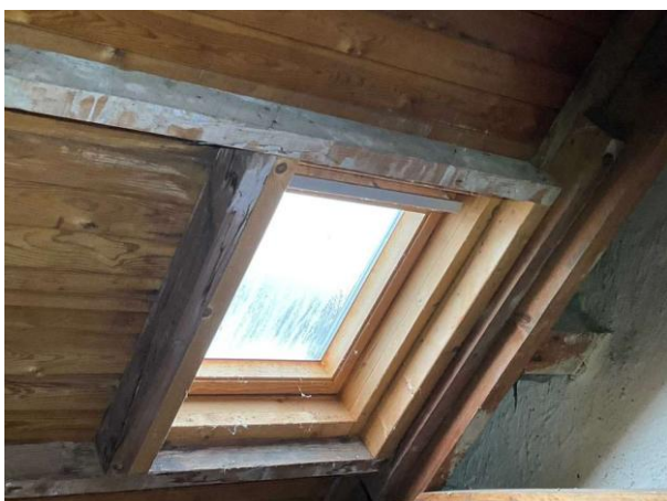
Bild 5: Utvändigt, Vind, Missfärgningar/fuktgenomslag noterades på vissa delar av insida yttertak.
