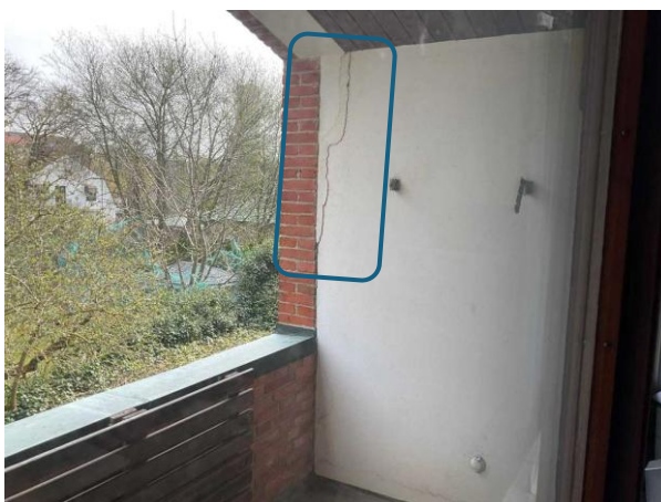
Bild 6: Utvändigt, Balkong, Sprickbildningar förekommer på väggarna som angränsar mot balkongen.
