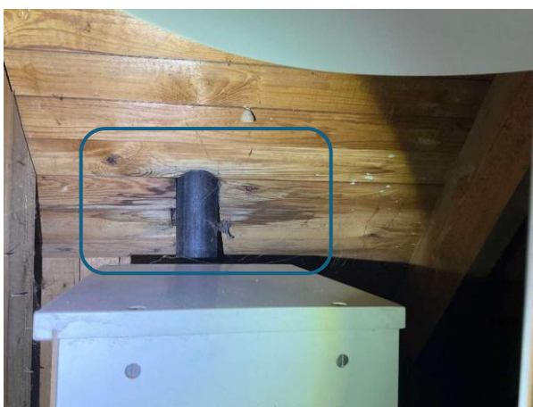
Bild 4: Utvändigt, Vind, Missfärgningar/fuktgenomslag noterades på vissa delar av insida yttertak.
