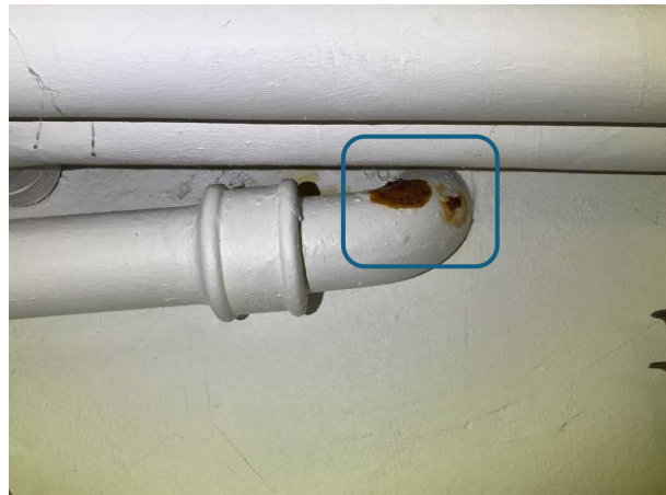
Bild 10: Invändigt, Källarplan, Finns rostangrepp/skada på del av gjutjärnsledning.
