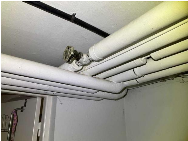
Bild 9: Invändigt, Källarplan, Förekommer äldre installationer som eventuellt erhållits med asbesthaltigt material.
