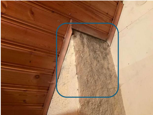
Bild 7: Invändigt, Övervåning, Missfärgningar noterades på insida yttertak mot murstock samt på murstock.
