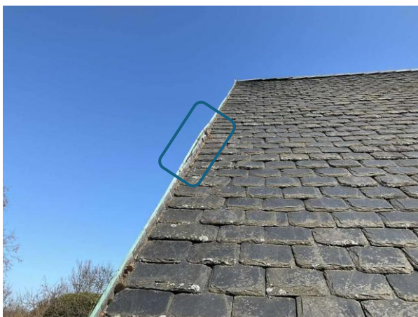
Bild 2: Utvändigt, Yttertak, Plåtdetalj vid vindskivor har på någon del tappat vidhäftning (lossnat).
