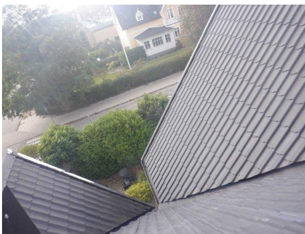
Bild 4: Utvändigt, Yttertak, Partiell rost och färgsläpp noterades på rännalsplåt, vattplåt samt vid plåtändar/plåtsslut.
