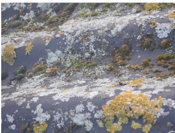
Bild 6: Utvändigt, Yttertak, Viss mosspåväxt förekommer på delar av taket innebärande ökad risk för fuktpåverkan.
