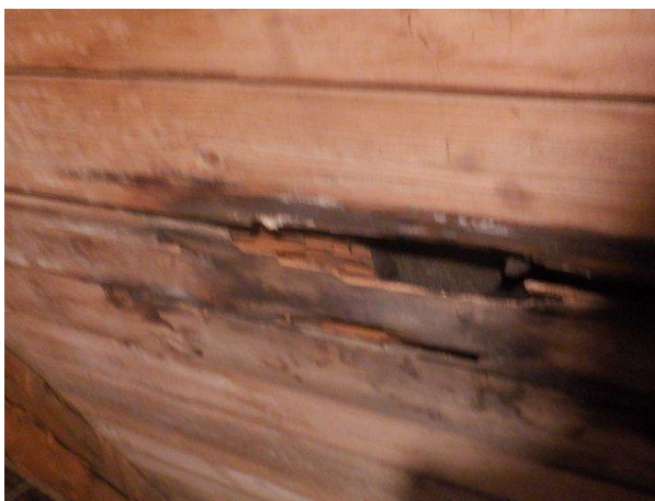
Bild 8: Utvändigt, Vind, Röta i svallbrädor, bakomliggande papp.
