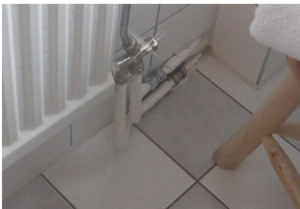
Bild 11: Invändigt, Övervåning, Rörinstallationer med bristfälligt utförande noterades.
