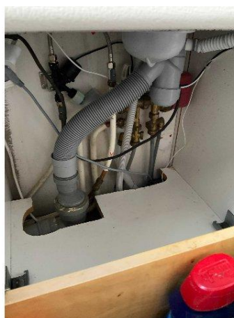
Bild 10: Invändigt, Entréplan, Diskbänkskåpets bottenstycke saknar heltäckande fuktskydd med tätning mot rör.
