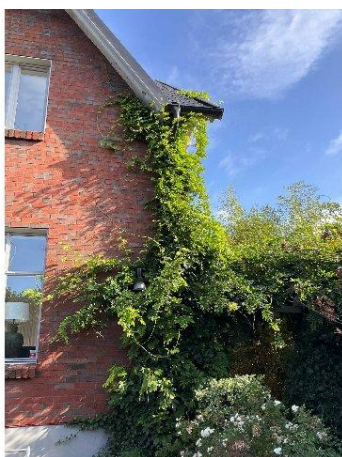
Bild 9: Utvändigt, Övrigt, Växtlighet mot huset samt på fasad kan bidra till slitage.
