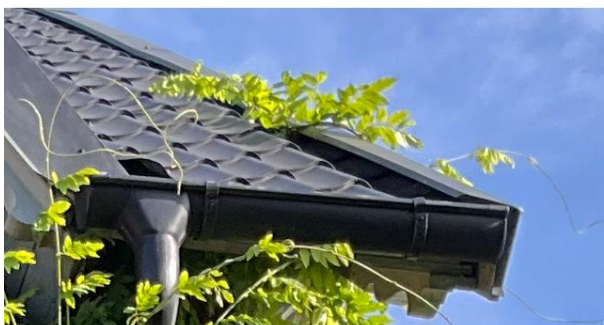
Bild 5: Utvändigt, Yttertak, Vattplåt/vindskiveplåt tätar på delar av taket bristfälligt mot takplåtbeklädnad.
