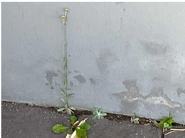
Bild 1: Utvändigt, Grundmur/Hussockel, Lokala sprickor och partiella puts-/färgsläpp noterades i grundmur.
