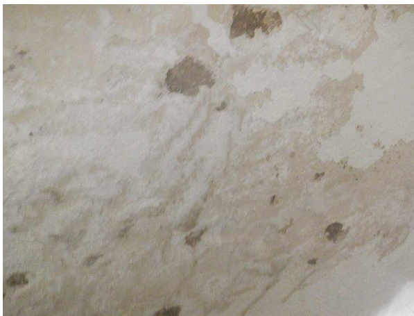
Bild 12: Invändigt, Källarplan, Missfärgningar på källaryttervägg.
