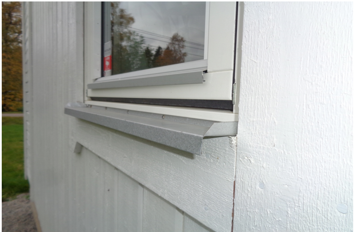
Bilden visar bakfall på fönsterbleck.
