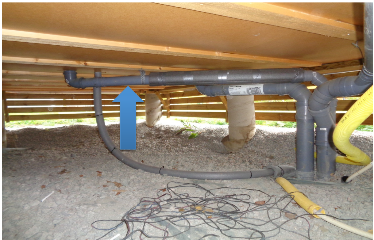
Bild på bakfall på tvättmaskinsavloppet "se pil"
