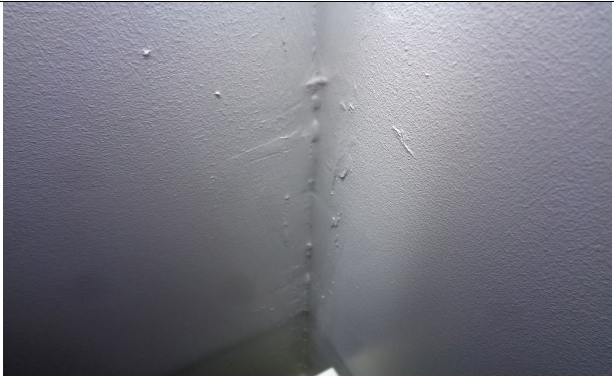
Bilden visar på bristfälligt målningsarbete.
