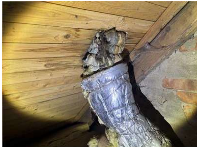
Missfärningar runt rörgenomföring på vind.
