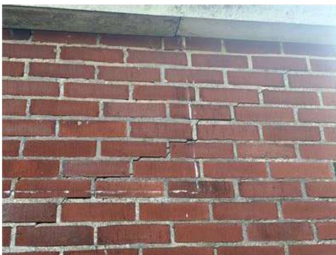
Sprickbildning i fasad
