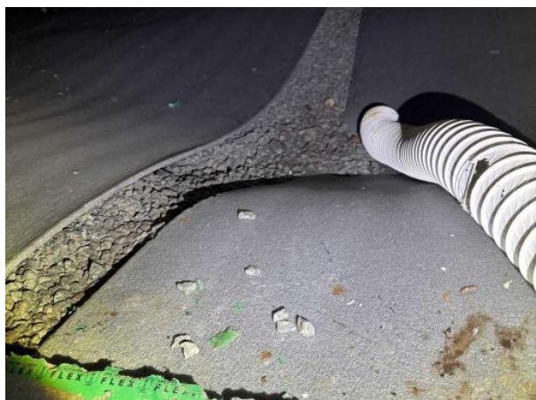
Bild 1: - Utvändigt, Grund, Isolemattan på marken är bristfälligt utlagd Röret för avfuktaren är delvis trasigt
