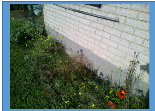
Marklutning mot husgrund
