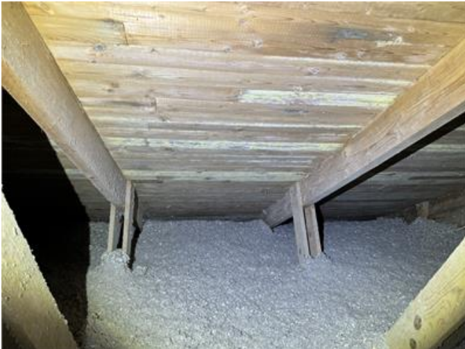
Missfärgningar på vindens underlagstak.
