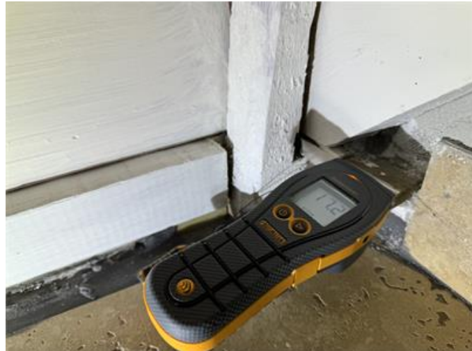
Fuktkvotmätning i träreger under trapp. Fuktkvoten i regel uppmättes till 17-18%FK Det kritiska gränsvärdet för mikrobiell tillväxt brukar anges till ca 15-17% fuktkvot (FK).
