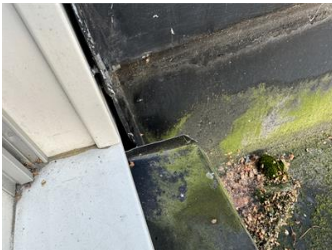
Otättheter mellan fönster och takkupans plåt.
