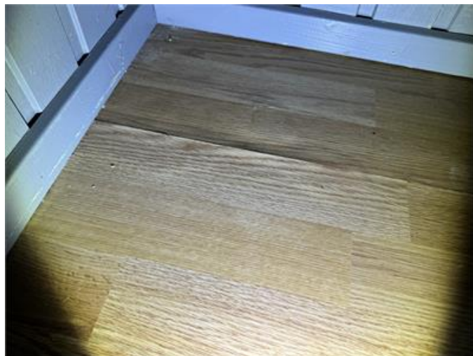
Golv som rest sig i källarens sovrums.
