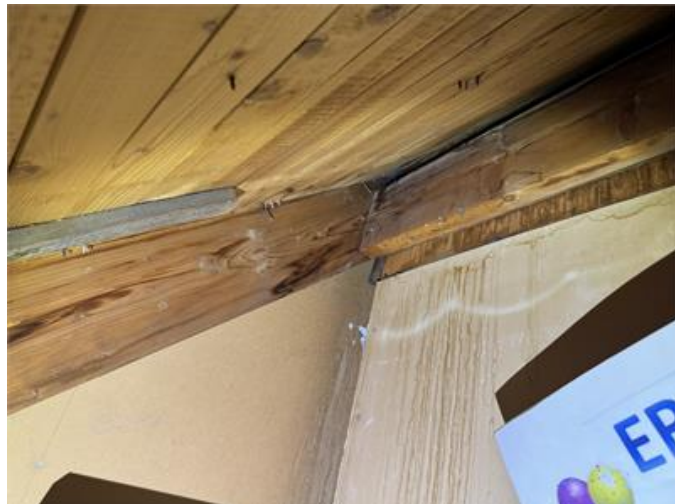
Rinnmärken och fuktfläckar på underlagstak och gipsskiva, bild tagen på vindsutrymmet.
