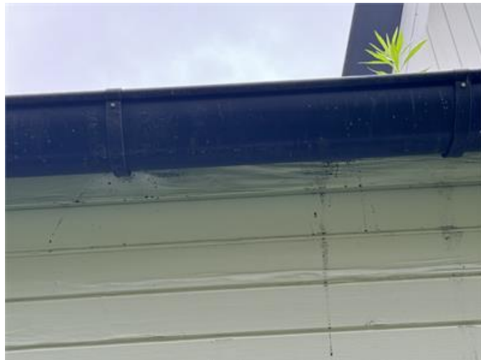
Färgsläpp/rötskador under hänggräna.
