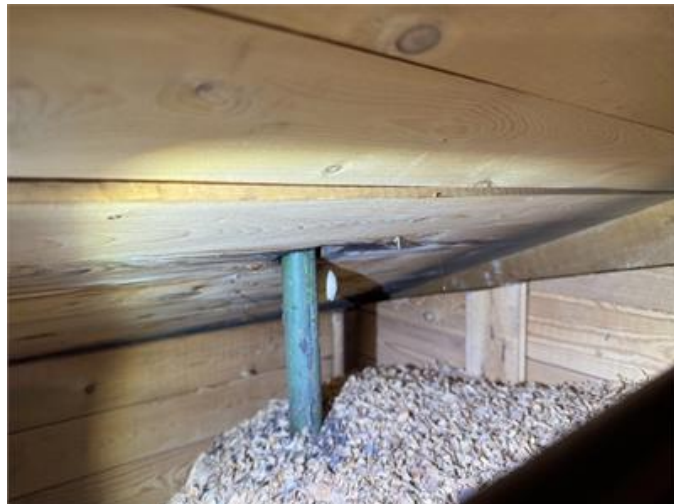
Bilden visar missfärgningar runt luftningsrör till expansionskärl.
