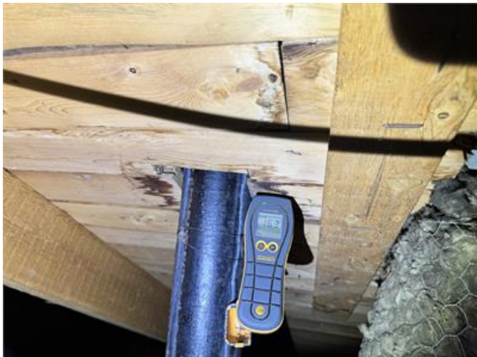
Fuktkvotsmätning runt genomföring i underlagstak.
