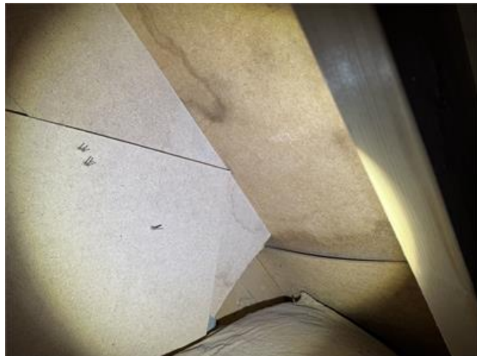
Fuktrosor på sidovindens underlagstak av board.
