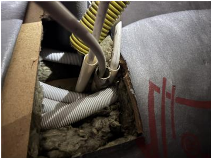
Synliga "oisolerade" installationer i krypgrunden.
