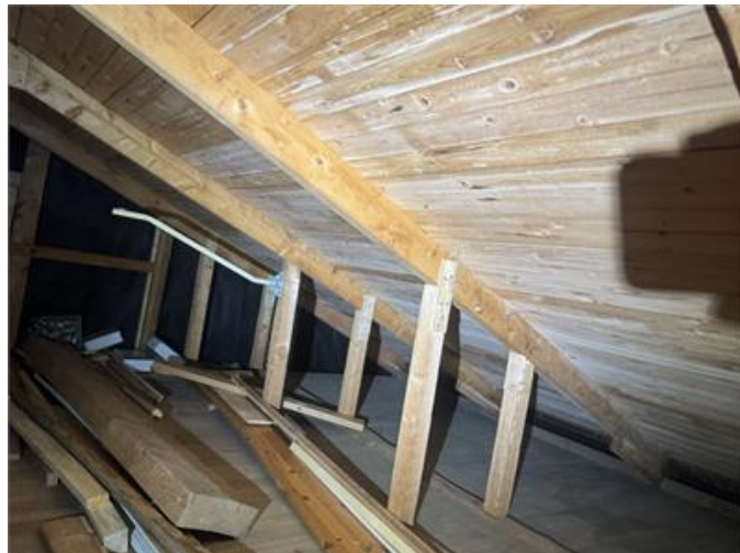
Mikrobiell påväxt på del av underlagstak.
