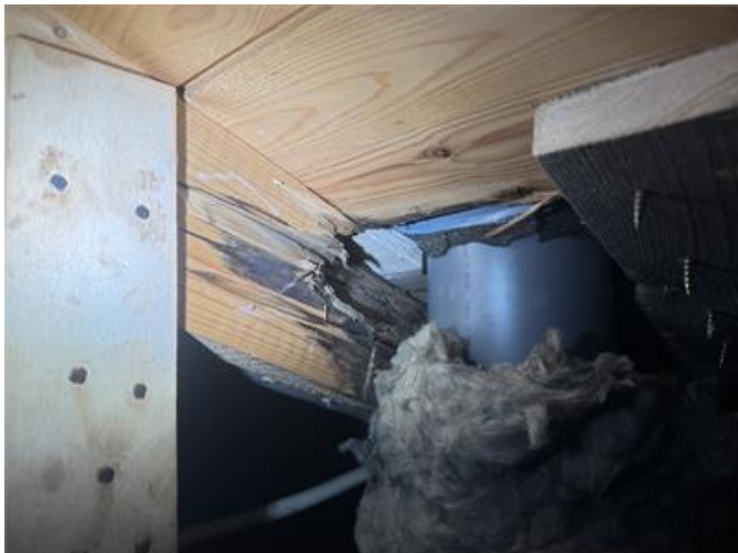
Rötskador i takstol i anknytning till avloppets avluftning.
