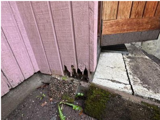
Rötskador i anknytning till baksidans ytterdörr "entréplan".
