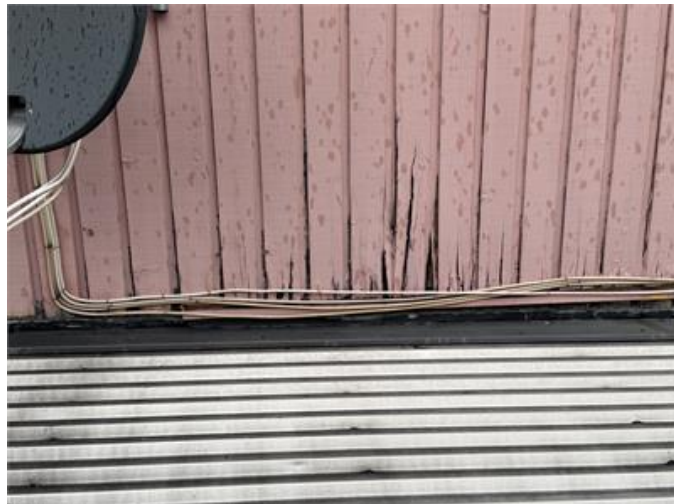
Rötskador i fasadpanel ovan låglutande tak.
