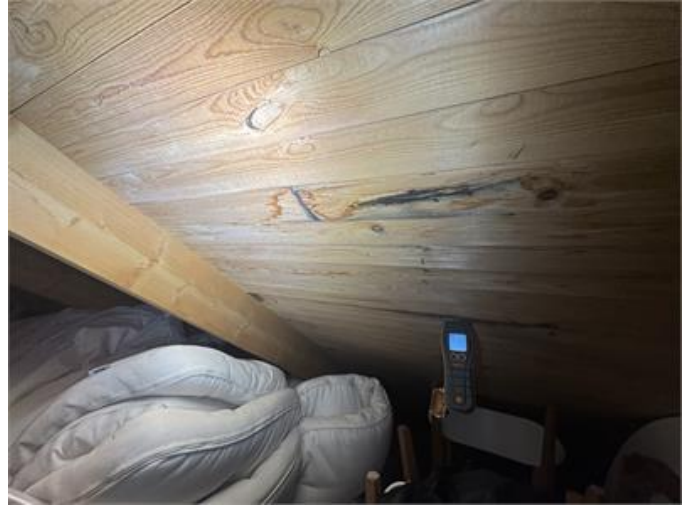
Fuktfläck på vindens underlagstak.
