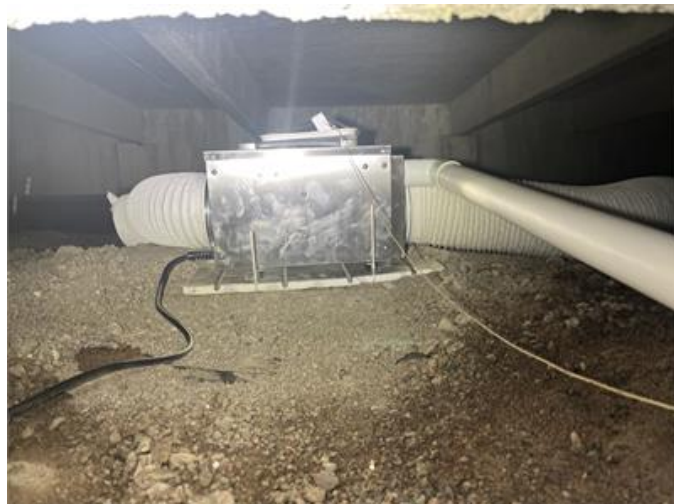
Krypgrundsavfuktare finns installerad i krypgrunden.
