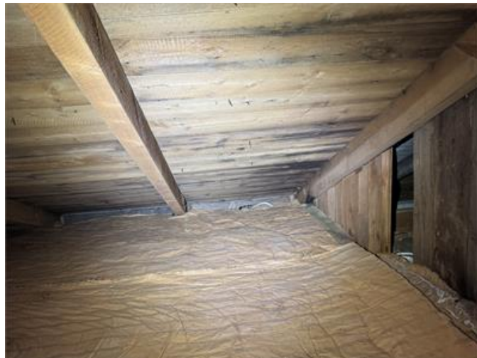
Bild visar mikrobiella missfärgningar på vindens underlagstak.
