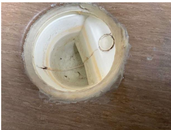
Bild 2: Invändigt, Övervåning, Duschrum wc, Äldre våtrum Plastmattan har släppt runt golvbrunnen Våtrumstapet släppt från väggen Det förekommer rörgenomföringar i golv annat än för avl...
