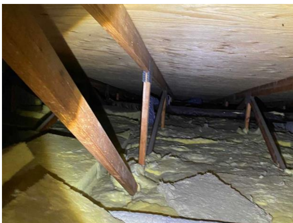
Bild 2: Utvändigt, Vind, Vinden är besiktad i anslutning till spång Lokalt vid luftningen till vinden noterades det Mikrobiell påväxt på underlagstaket
