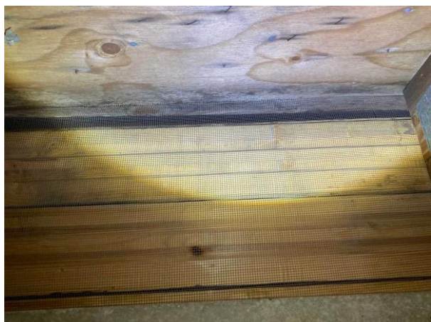
Bild 1: Utvändigt, Vind, Vinden är besiktad i anslutning till spång Lokalt vid luftningen till vinden noterades det Mikrobiell påväxt på underlagstaket
