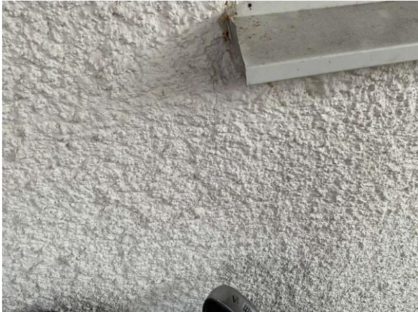
Bild 1: Utvändigt, Fasad, Det noterades sk. bomljud på fasaden Sprickor noterades i putsen Fogen i skarvar mot grannar har släppt
