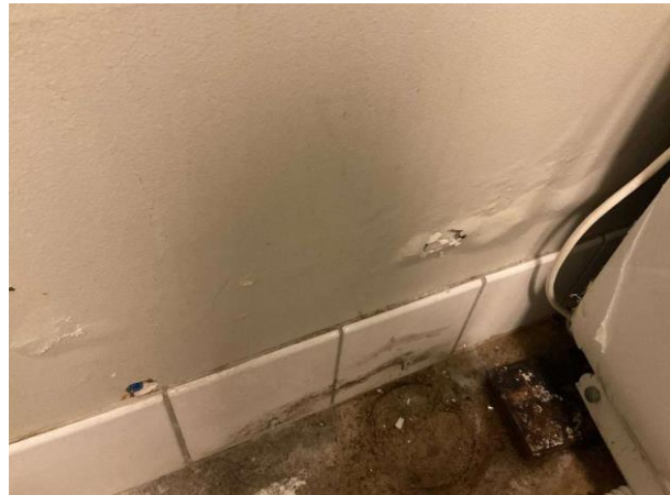
Bild 4: Invändigt, Souterrängplan, Badrum, Äldre våtrum Gjutjärnsgolvbrunn (rost noterades i brunnen) Putssläpp noterades på en vägg Se riskanalys
