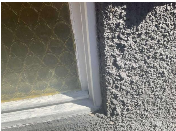
Bild 1: Utvändigt, Grundmur/Hussockel, Spricka färgsläpp noteras på grundmuren
