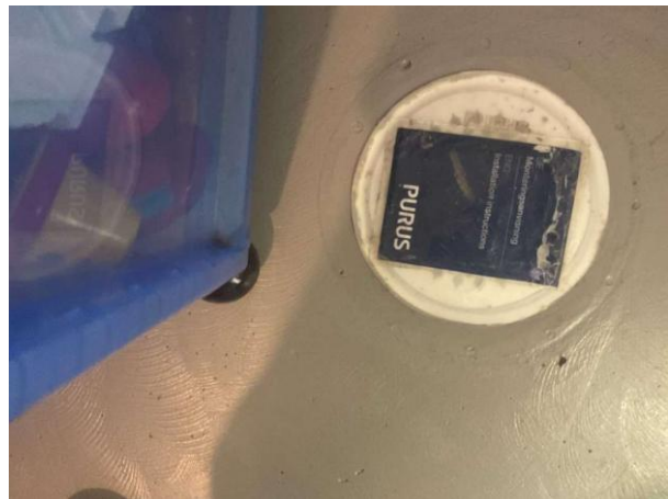
Bild 10: Invändigt, Källarplan, Pannrum, En golvbrunn är inte använd plasten är kvar
