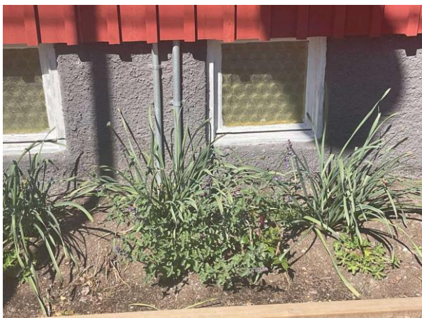
Bild 3: Utvändigt, Fönster, Fönsterbleck saknas på källarfönster Färgsläpp noteras på äldre källarfönster
