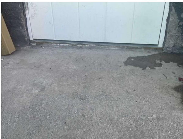
Bild 4: Utvändigt, Ytterdörr, Tröskelplåt saknas på källardörren
