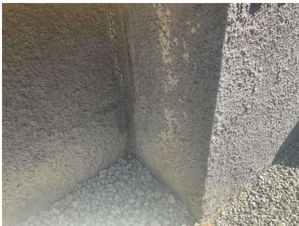
Bild 2: Utvändigt, Grundmur/Hussockel, Spricka färgsläpp noteras på grundmuren
