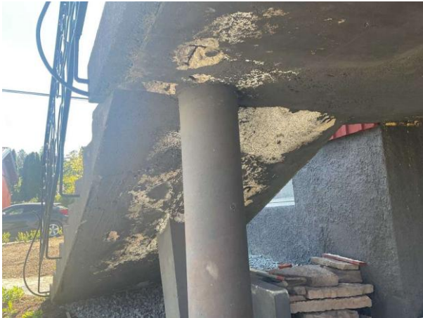
Bild 7: Utvändigt, Utvändigt entrétrappa, Synlig armering noteras i underkant på entrétrappan Sprickor och putssläpp noteras på trappan
