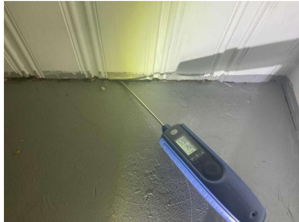
Bild 8: Invändigt, Källarplan, Hall, Fuktkontroll utförd i inkläddkällarvägg under gränsvärde se bilaga 4
