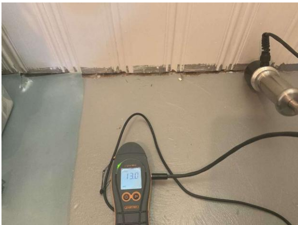
Bild 9: Invändigt, Källarplan, Hall, Fuktkontroll utförd i inkläddkällarvägg under gränsvärde se bilaga 4
