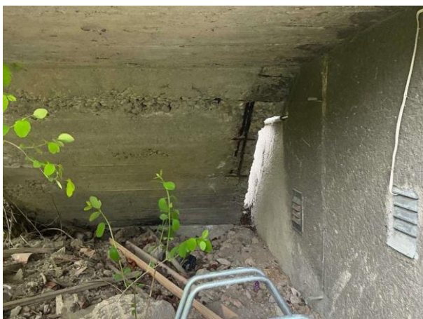
Bild 5: Utvändigt, Övrigt, Betongsläpp samt rostig armering noterades under entretrappen
