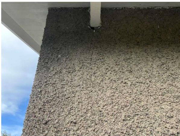
Bild 2: Utvändigt, Fasad, Spricka noterades i fasaden
