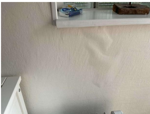
Bild 10: - Invändigt, Soutterrängplan, Tapeten har släpp från väggen
