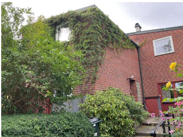
Bild 3: - Utvändigt, Fasad, Klänger växter noteras på fasaden
