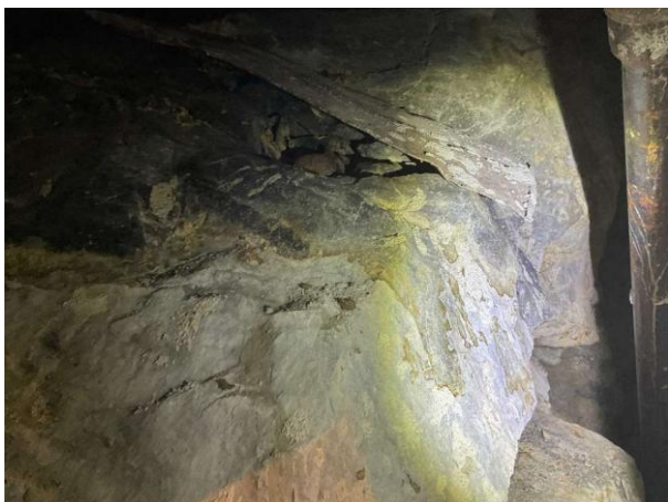
Bild 11: Invändigt, Soutterrängplan, Lokalt noteras lite markfukt på berget
