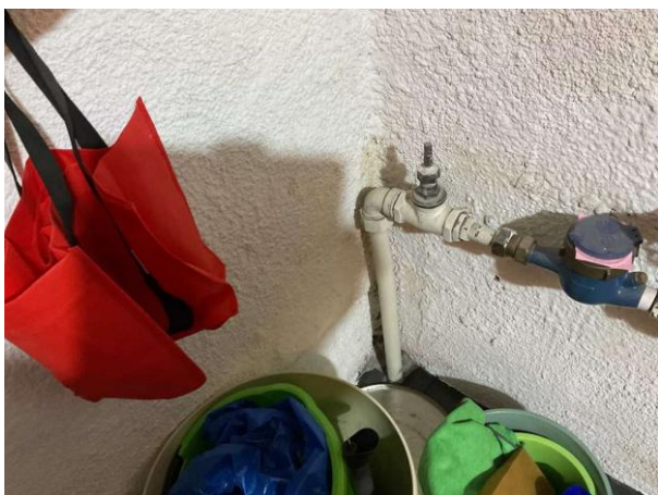
Bild 9: Invändigt, Soutterrängplan, Missfärgning noteras på ytterväggshörn
