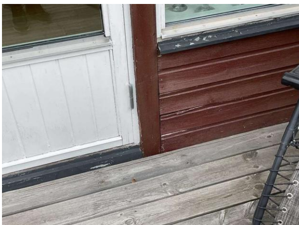
Bild 1: - Utvändigt, Fasad, Torrspirckor och färgsläpp noteras på träfasaden
