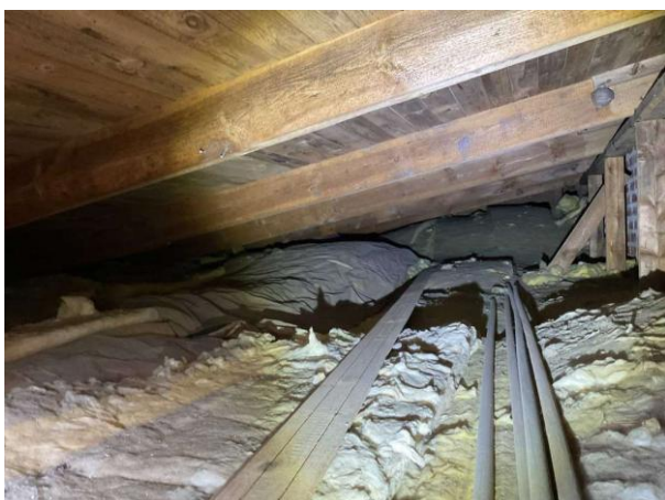
Bild 5: - Utvändigt, Vind, Lokalt noteras mikrobiellpåväxt på underlagstaket
