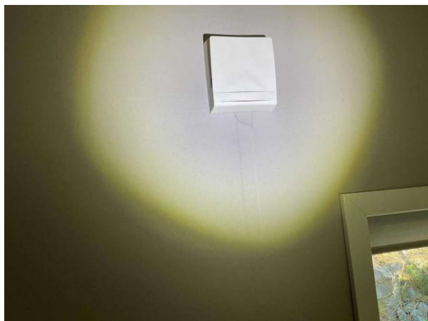
Bild 3: - Invändigt, Entréplan, Rinnmärken noteras under tilluftsventilen på väggen Torrt vid besiktningstillfället
