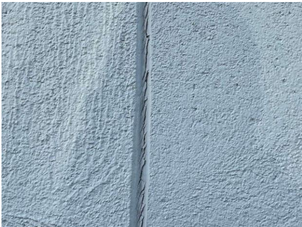
Bild 1: - Utvändigt, Grundmur/Hussockel, Torrspäckor noteras på fogar mellan betongelement
