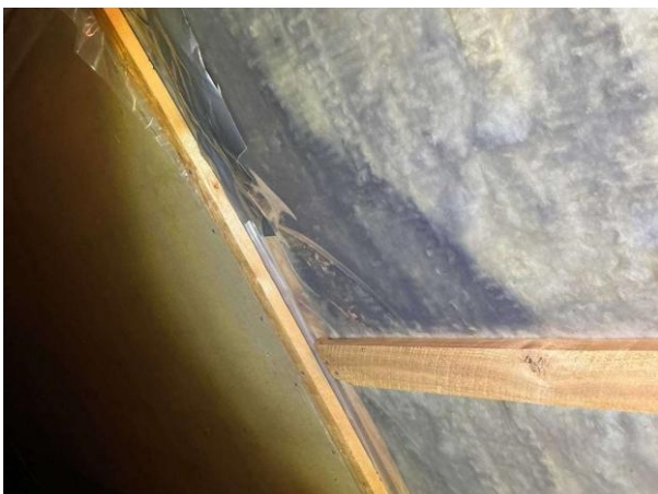
Bild 5: - Utvändigt, Vind, missfärgning noteras lokalt på isoleringen monterat på underlagstaket
