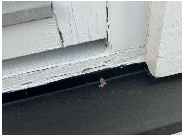
Bild 4: - Utvändigt, Fönster, färgsläpp och torrspäckor noteras på fönster
