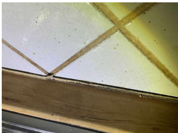
Bild 13: - Invändigt, Entréplan, Bristfällig mjukfog kring bänkskiva...
