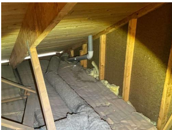
Bild 2: - Utvändigt, Vind, Fuktbläck på golvet under luftning till avlopp Lokal mikrobiell påväxt på underlagstaket Se riska...
