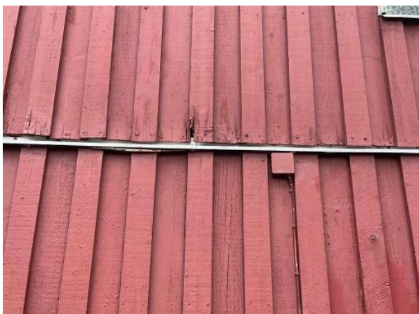
Bild 1: - Utvändigt, Fasad, Längdskarvar finns på fasaden Röttskadad panel noterades Se riskanalys
