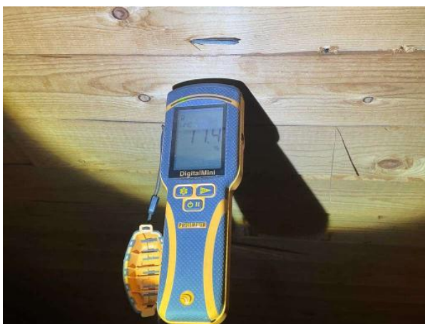
Bild 4: - Utvändigt, Vind, Fuktbläck på golvet under luftning till avlopp Lokal mikrobiell påväxt på underlagstaket Se riska...
