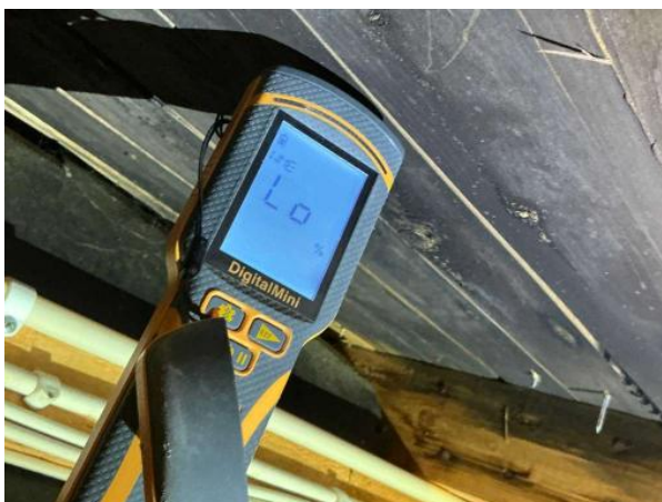
Bild 2: - Invändigt, Övervakning, Lokal mikrobiell påväxt. Se riskanalys vid inga förhöjda fuktvärden noterades.
