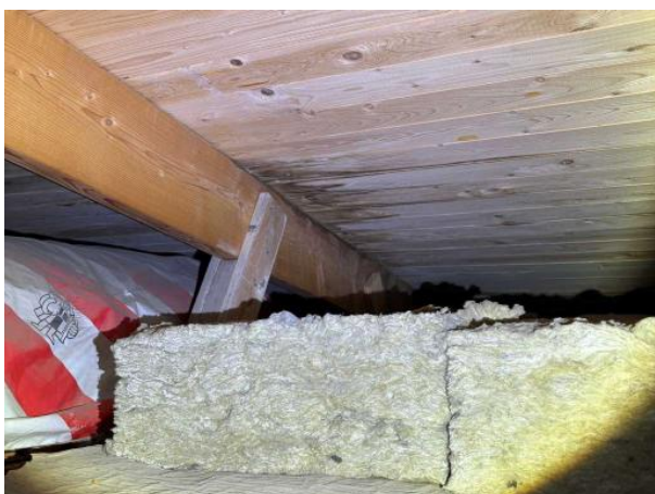
Bild 3: - Utvändigt, Vind, Spår av läckage noterades ovan garaget
