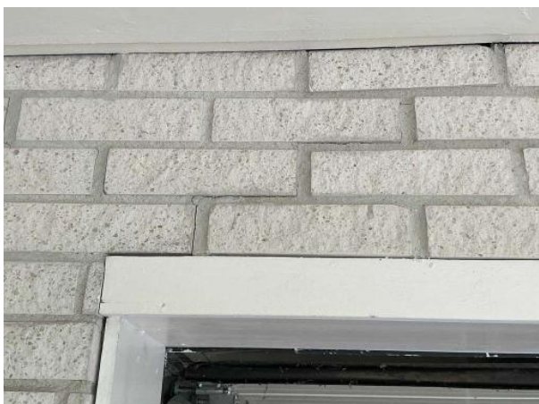
Bild 1: Utvändigt, fasad, spricka ovan garageporten
