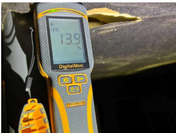
Bild 2: Utvändigt, Grund, Krypgrundsavfuktare är installerat, när en avfuktare är installerad anses grunden som fuktsäkrad
