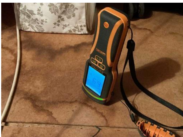
Bild 5: - Utvändigt, Vind, Fuktläckor noterades på golvet på vinden (torrt vid besiktningstillfället) Spår av läckage noter...
