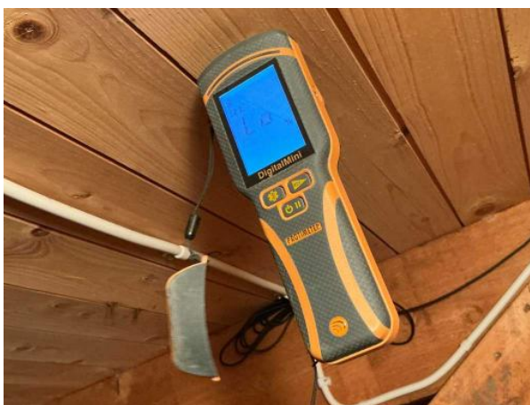
Bild 4: - Utvändigt, Vind, Fuktläckor noterades på golvet på vinden (torrt vid besiktningstillfället) Spår av läckage noter...
