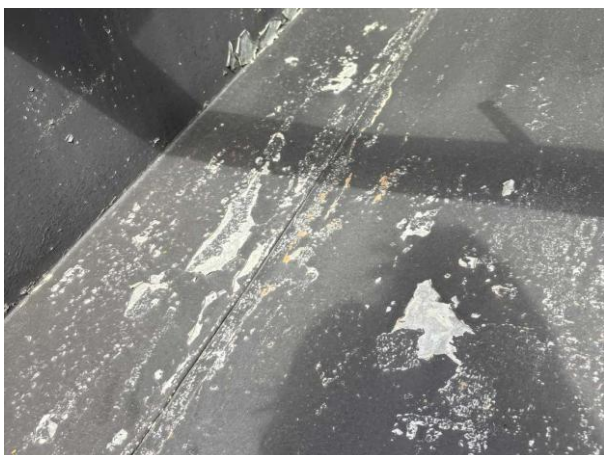
Bild 3: - Utvändigt, Yttertak, Färgsläpp finns på takplåtar Taket är besiktat i anslutning till taksäkerhet
