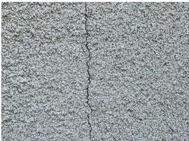
Bild 1: Utvändigt, Fasad, Sprickor samt bomljud noterades i putsen
