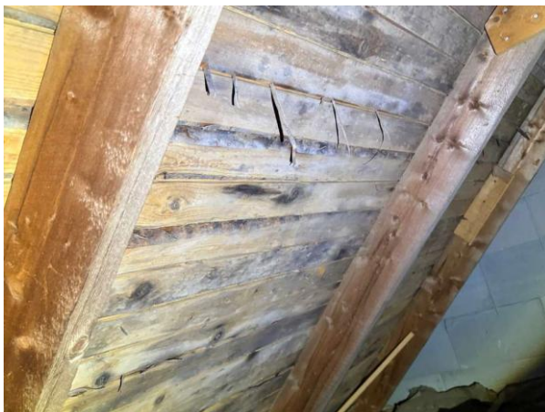
Bild 2: - Utvändigt, Vind, Mikrobiell påväxt på underlagstaket
