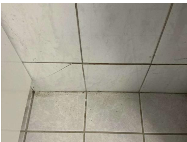
Bild 6: - Invändigt, Souterrängplan, Sprickor i klinkerplattor Kakelplattor har släppt på vägg Golvbrunnen är väggnära monterad Brunns...
