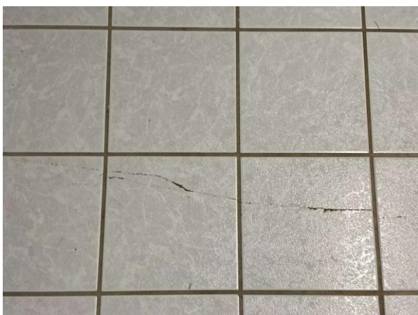
Bild 5: - Invändigt, Souterrängplan, Sprickor i klinkerplattor Kakelplattor har släppt på vägg Golvbrunnen är väggnära monterad Brunns...
