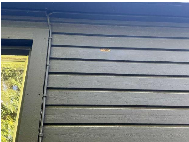
Bild 3: Utvändigt, Fasad, Hål i fasaden (från en gammal luft luftvärmepump)
