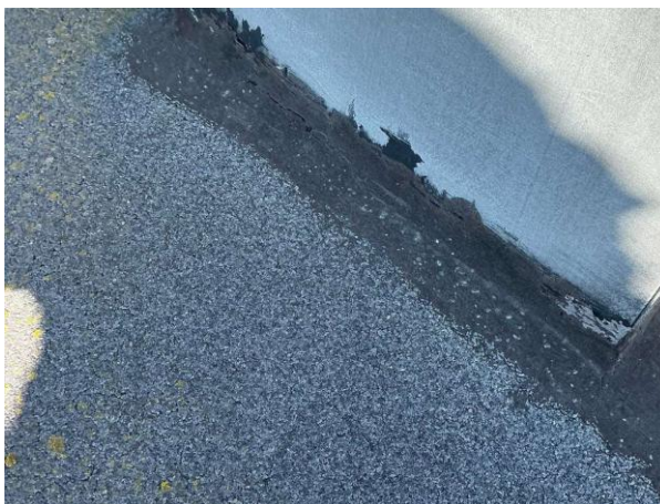
Bild 4: - Utvändigt, Yttertak, Äldre tak Uppvik av papp saknas mot genomföringar samt gummistos Ytsprickor noterades på takpapp...
