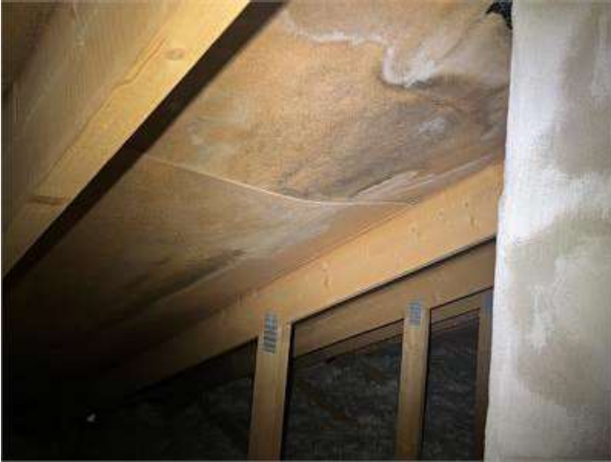
Bilden visar del av vinden med lokala fuktfläckar på underlagstak av masonit.
