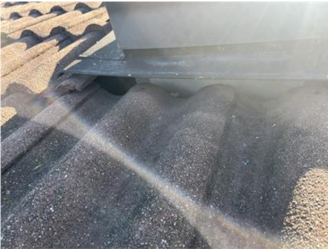
Tätning bör förbättras mellan plåtbeslag och takpannor.
