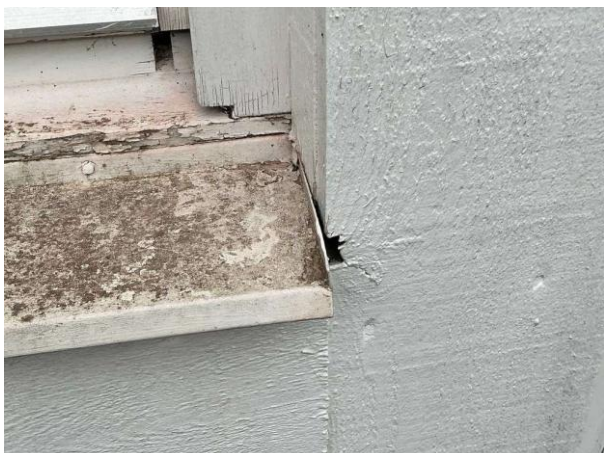
Bild 5: - Utvändigt, Fönster, Äldre isolerglaskassetterbristfälligt tätat mellan fönsterbleck och fasad...
