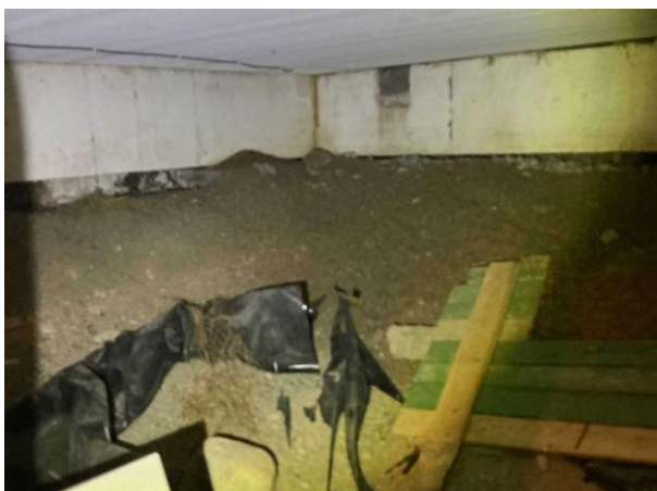
Bild 1: - Utvändigt, Grund, Krypgrund Lätt/betongbjälklag med uppreglade golv Fukt noteras på sanden i grunden Organiskt mate...
