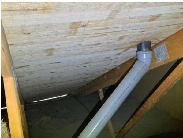
Bild 6: Utvändigt, Vind, Lokalt på vinden noteras det mikrobiell påväxt på underlagstaket
