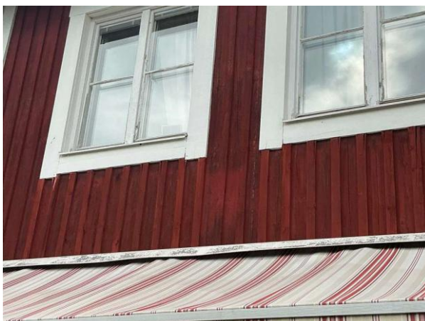
Bild 2: Utvändigt, Fasad, Färgsläpp och torrsprickor noteras på panelen
