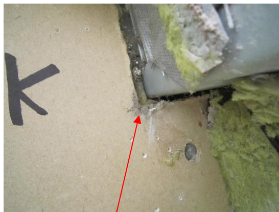
Foto 24 Synlig missfärgning på yttre gipsskiva vid fönsterbleck
