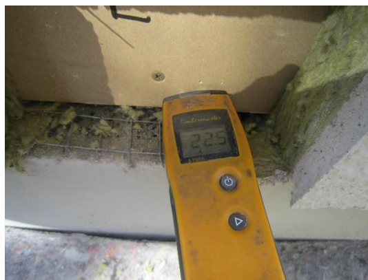
Foto 12 Fuktindikering i yttre gipsskiva
