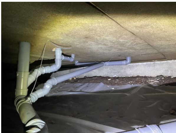
Bild 2: Utvändigt, Grund, Uteluftventilerad kryppgrund Lokalt noters mikrobielpåväxt på bjälklagsbotten
