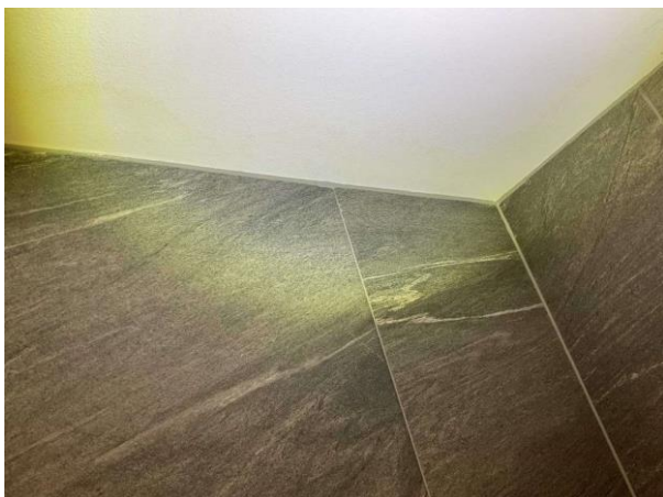
Bild 3: Invändigt, Entréplan, Badrum, Missfärgning noteras på innertak ovan badkar
