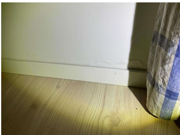
Bild 1: Invändigt, Betongplatta på mark, Gästrum, Lokalt på väggen bubblar sig färgen (färgsläpp)
