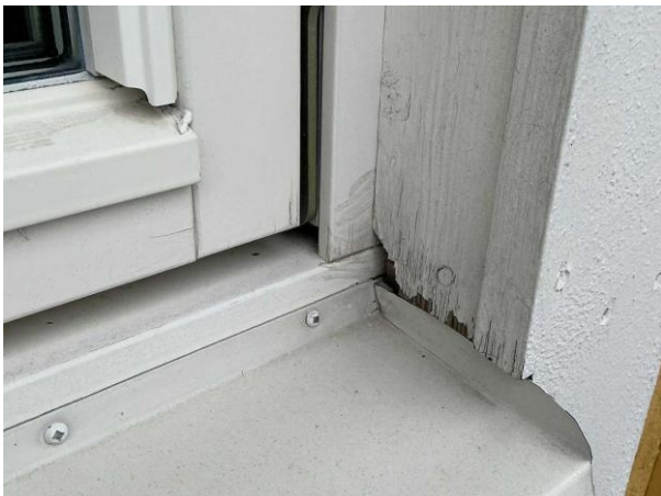
Bild 3: - Utvändigt, Fönster Otäta anslutningar mot fönster
