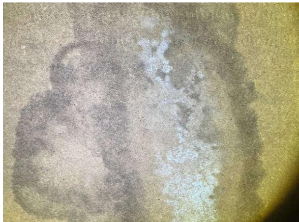
Bild 4: - Utvändigt, Vind, Spår av tidigare läckage
