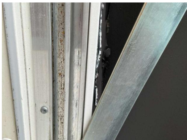
Bild 9: Invändigt, Övervakning, Otät plåtanslutning mot fönster (utvändigt vid kupan)
