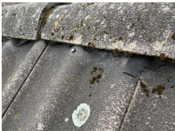
Bild 6: - Utvändigt, Yttertak, Äldre tak, Nocktätningen är trasig
