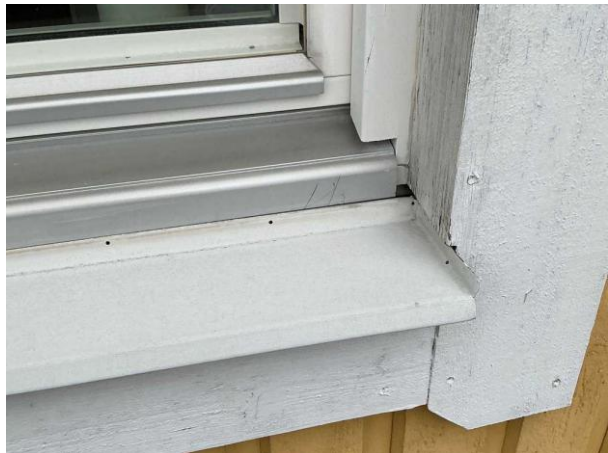
Bild 2: - Utvändigt, Fönster, Ett löst fönsterbleck
