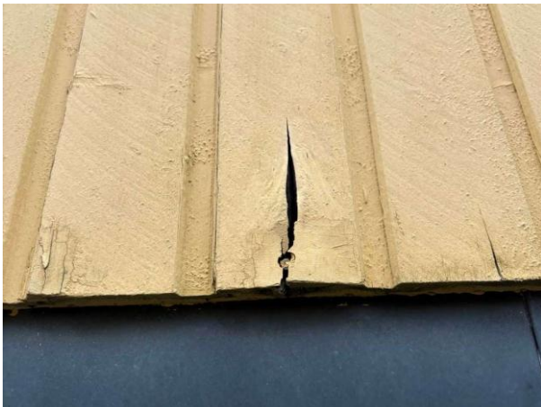
Bild 1: - Utvändigt, Fasad, Enstaka rötskadade panelbrädor noterades på gavel Missfärgningar på fasaden
