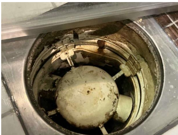
Bild 10: - Invändigt, Entréplan, Avlopp under handfat sticker ej upp ur golv Golvbrunnen är inte utbytt vid tidigare renovering ...
