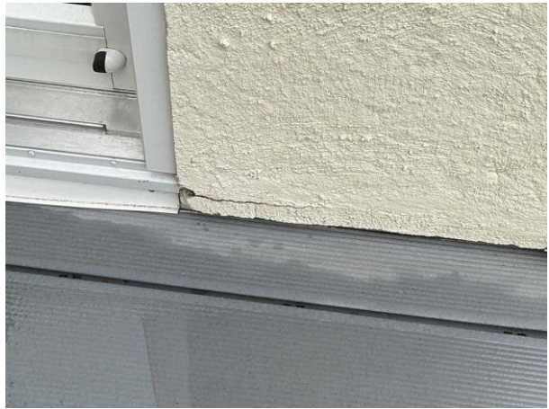
Bild 4: - Utvändigt, Fasad, Rötskador i panel nedre kant noterades på gavel samt baksida och fönsterfoder Lös puts vid glasparti
