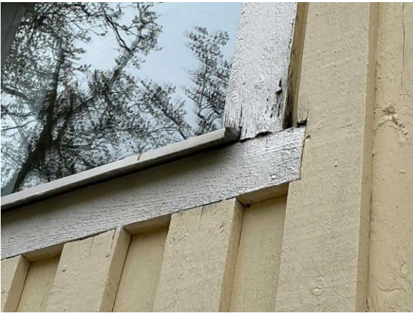
Bild 3: - Utvändigt, Fasad, Rötskador i panel nedre kant noterades på gavel samt baksida och fönsterfoder Lös puts vid glasparti
