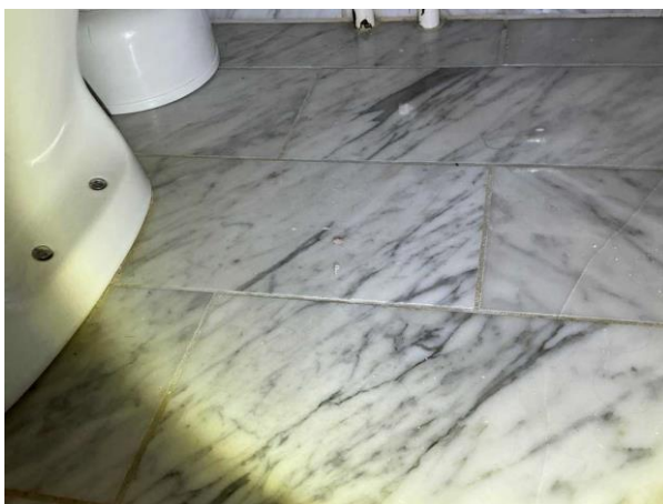
Bild 8: - Invändigt, Souterrängplan, Äldre våtrum Det förekommer rörgenomföringar i golv annat än för avlopp Lucka till rörstam är int...
