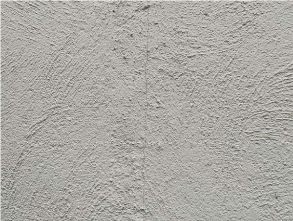
Bild 1: Utvändigt, Grundmur/Hussockel, Mindre spricka mellan ursprunglig byggnad och tillbyggnad
