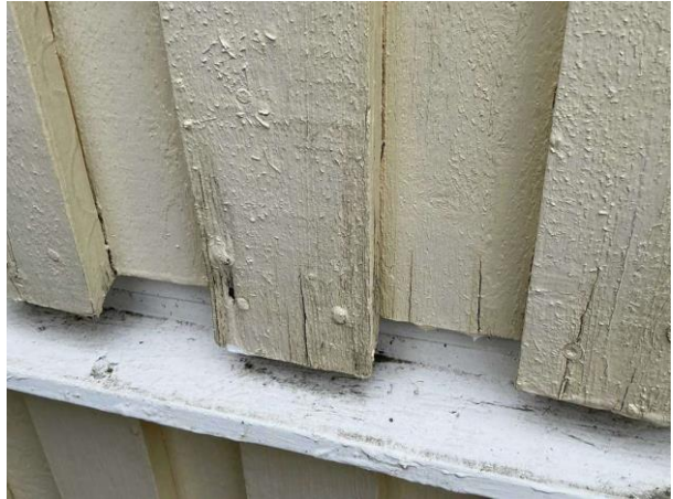
Bild 2: - Utvändigt, Fasad, Rötskador i panel nedre kant noterades på gavel samt baksida och fönsterfoder Lös puts vid glasparti
