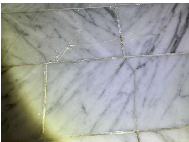
Bild 7: - Invändigt, Souterrängplan, Äldre våtrum Det förekommer rörgenomföringar i golv annat än för avlopp Lucka till rörstam är int...
