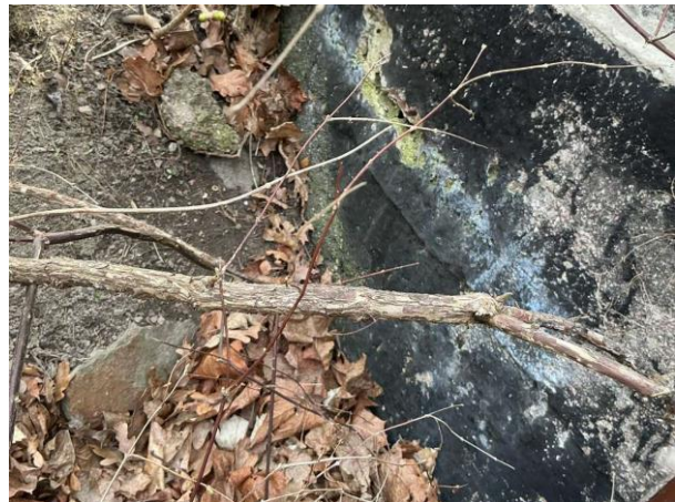
Bild 2: - Utvändigt, Grundmur/Hussockel, Lös fog noterades mellan granitsten Utslag hål i grundmur
