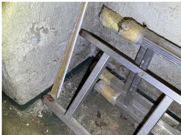
Bild 12: - Invändigt, Garage, Lös puts fuktgenomslag i grundmurar Bristfällig elinstallation (inga övriga installationer har be...
