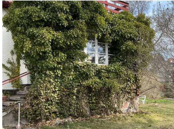
Bild 4: - Utvändigt, Fasad, Fasadpanel är missfärgad Delvis är fasaden svår att besikta pga buskar och klångväxter
