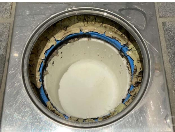
Bild 11: - Invändigt, Övervåning, Okänd ålder Brunnsduken är inte korrekt tillskuren och sticker ut under klämringen Tätskikt döje...
