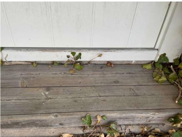
Bild 5: - Utvändigt, Ytterdörr, Färgsläpp på balkongdörr övre plan Tröskelbleck saknas nedre plan
