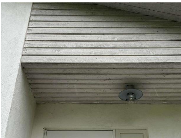
Bild 4: - Utvändigt, Fasad, Tilläggsisolerad fasad utan luftspalt se riskanalysen Urslag ur fasadputs Otätt runt stuprör Måln...
