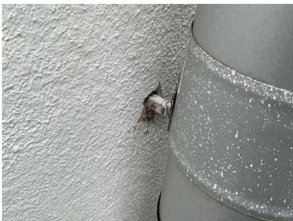
Bild 3: - Utvändigt, Fasad, Tilläggsisolerad fasad utan luftspalt se riskanalysen Urslag ur fasadputs Otätt runt stuprör Måln...
