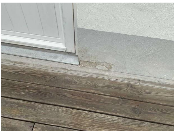
Bild 5: - Utvändigt, Fasad, Tilläggsisolerad fasad utan luftspalt se riskanalysen Urslag ur fasadputs Otätt runt stuprör Måln...
