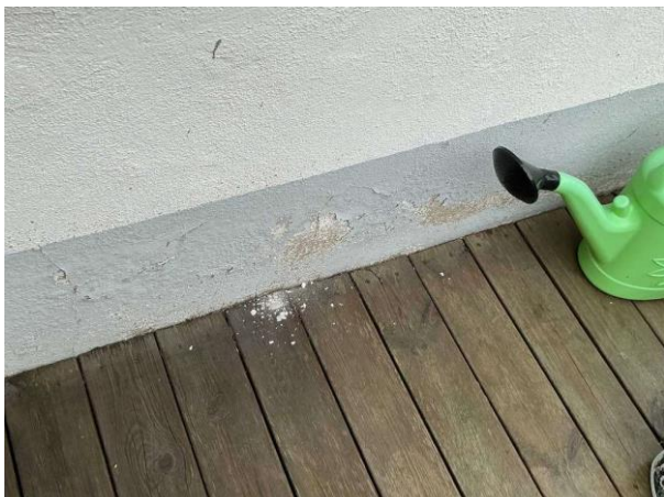
Bild 1: Utvändigt, Grundmur/Hussockel, Färgsläpp på sockel samt lös puts noterades lokalt på baksidan
