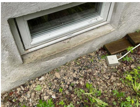
Bild 6: Utvändigt, Fönster, Bleck saknas på källarfönster
