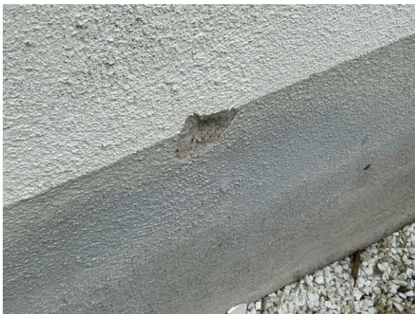
Bild 2: - Utvändigt, Fasad, Tilläggsisolerad fasad utan luftspalt se riskanalysen Urslag ur fasadputs Otätt runt stuprör Måln...
