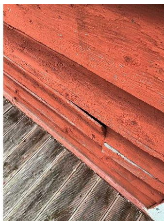
Bild 2: Utvändigt, Fasad, Vriden och sprucken träpanel samt färgsläpp och viss rötskada noterades se riskanalysen
