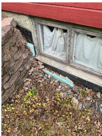
Bild 3: Utvändigt, Mark, Äldre dränering, en dränerings tekniska livslängd beräknas till 25år, om det är rätt utfört och m...
