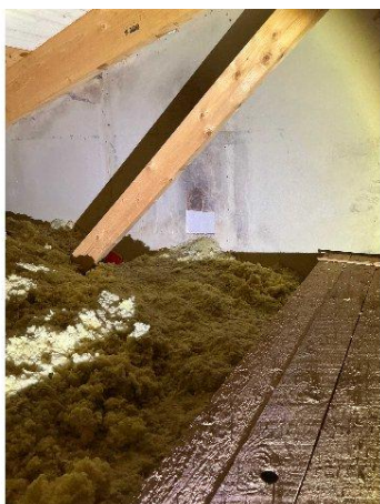
Bild 1: - Utvändigt, Vind, Missfärgning på vägg
