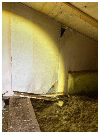
Bild 2: - Utvändigt, Vind, Delar av gipsen saknas
