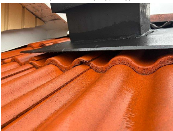
Bild 3: Utvändigt, Yttertak, Det är otätt mellan plåt och betongpannor vid genomföring
