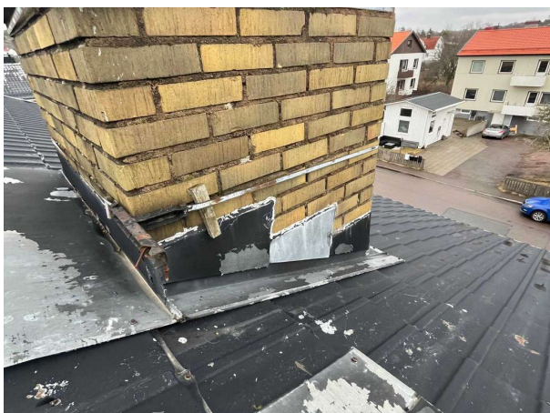
Bild 7: Utvändigt, Tak, Färgsläpp noteras på flera ställen på taket. Rekommenderar kontakt med behörig fackman för lämpli...
