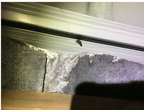
Bild 10: Utvändigt, Vind, Droppläckage noteras vid skruvar för plåttak. Rekommenderar kontakt med behörig fackman för lämpli...
