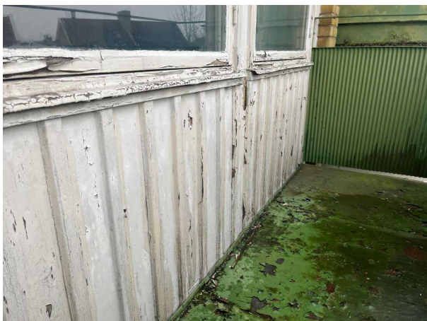
Bild 3: Utvändigt, Fasad, Träfasaden uppvisar behov av underhåll/renovering i form av färgsläpp på flera ställen.
