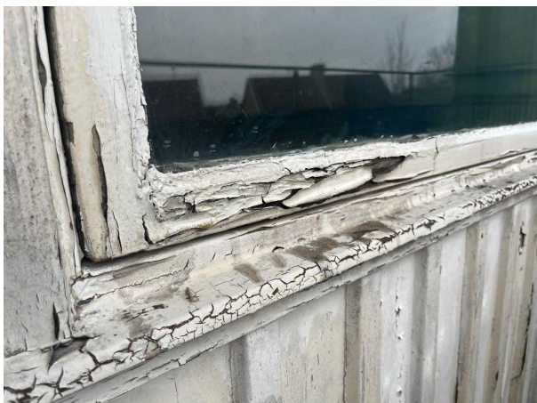
Bild 5: Utvändigt, Fönster/Dörrar, Fönster och fönsterdörrar är i dåligt skick och i behov av underhåll/byte. Omfattande färgsläpp n...
