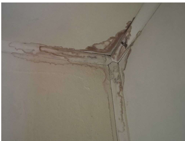
Bild 16: Invändigt, Plan 1, Fuktrosor noteras på vägg mot våtrum samt i tak. Området var torrt vid besiktningsstillfället. För...
