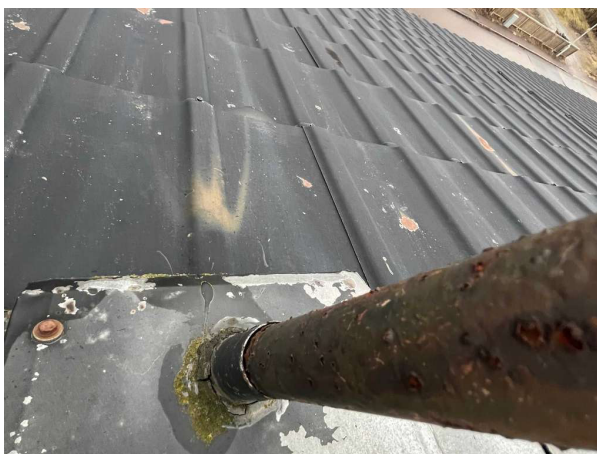
Bild 8: - Utvändigt, Tak, Otät genomföring för expansionskärl noteras. Se även notering vind.
