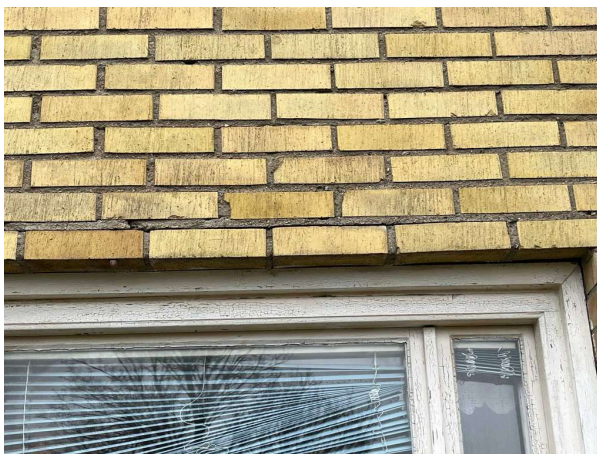
Bild 4: Utvändigt, Fasad, Sprickor noteras i tegelfasadens fogar ovan fönster. Detta orsakas ofta av att armeringsjärn i fo...
