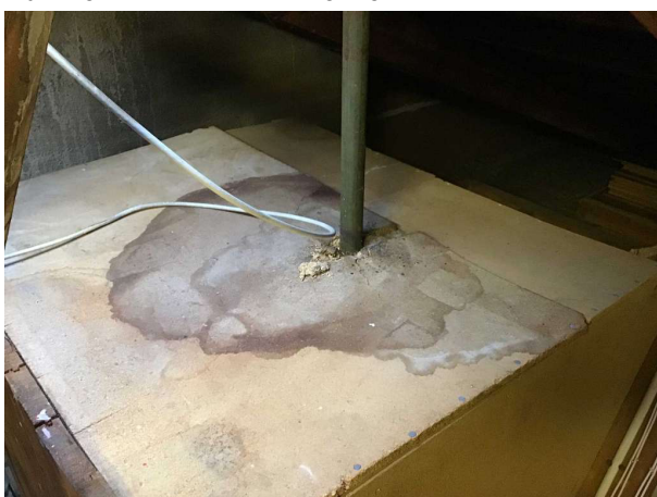
Bild 11: Utvändigt, Vind, Äldre expansionskärl noteras på vinden. Detta bör om möjligt tas bort och genomföring i tak tätas...
